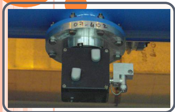
Использование стационарных датчиков частичных разрядов, установленных на заводе – изготовителе КРУЭ
