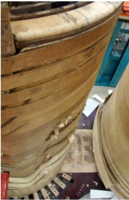
Fig 5. „buckling“ of LV-winding phase „W“
